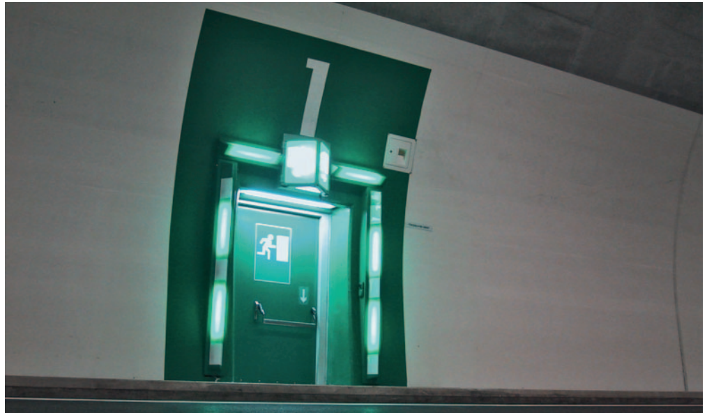
4 Beleuchtete Fluchttür zum Sicherheitsstollen
