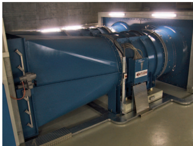
3 Abluftventilatoren 3 Exhaust fans
