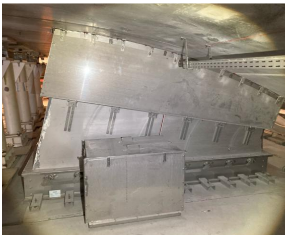
Entrauchungsklappe auf der beweglichen Zwischen- decke mit beweglichem Anschluss an den Abluftstichkanal (von der Zwischendecke zum Abluftkanal unter der Fahrbahn)
