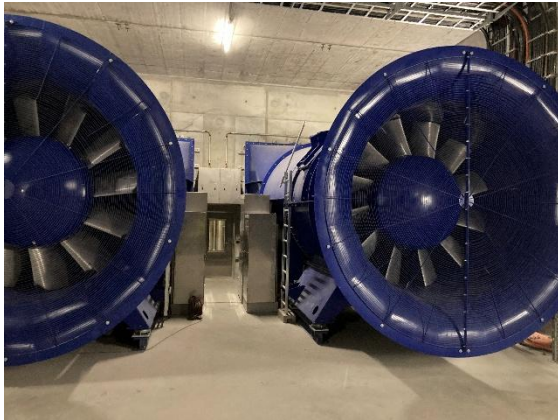
Abluftventilatoren zur Rauchabsaugung in der Weströhre
