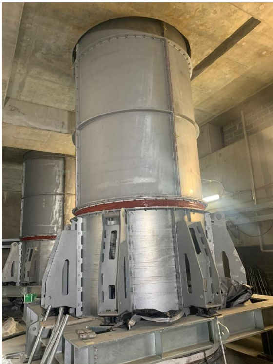
Uno dei cinque ventilatori assiali disposti in verticale
