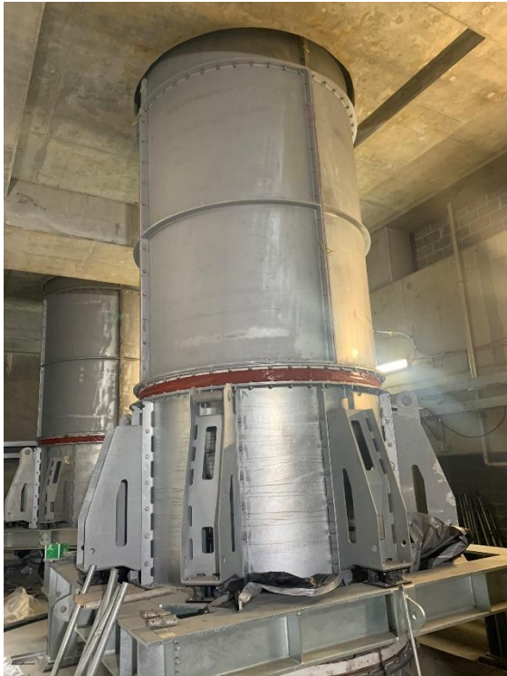
Un des cinq ventilateurs axiaux agencés verticalement
