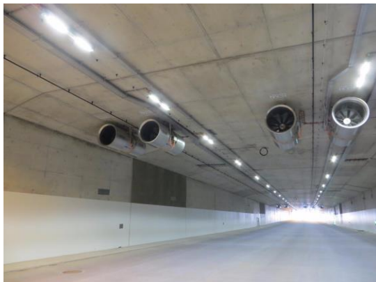
Ventilatori jet nella sezione del vano traffico
