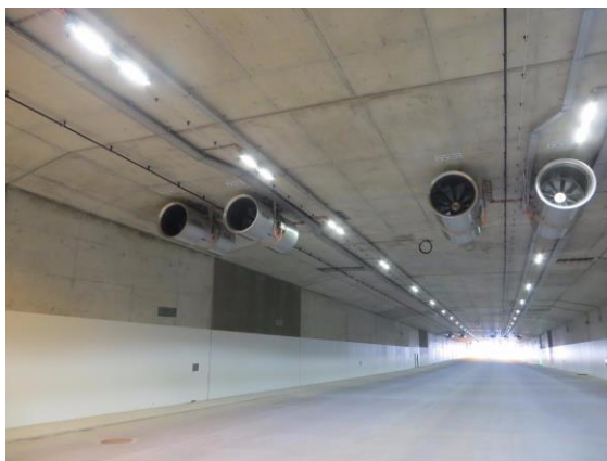
Ventilateurs de jet dans la zone de la circulation
