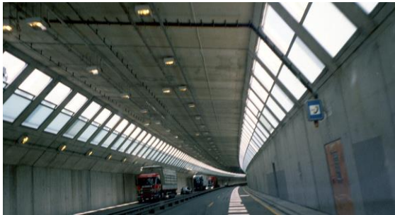
Tunnelquerschnitt mit Schiebefenster zur Entrauchung
