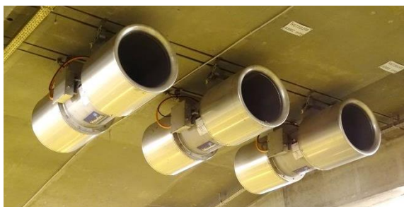
Gruppo di ventilatori nel Heckenstallertunnel
