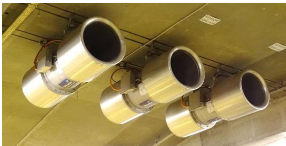
Ventilatorgruppe im Heckenstallertunnel
