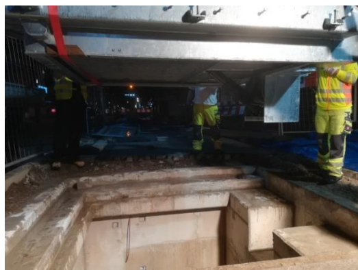
Valvola per la chiusura del condotto prima del montaggio nella sede della copertura della fermata
