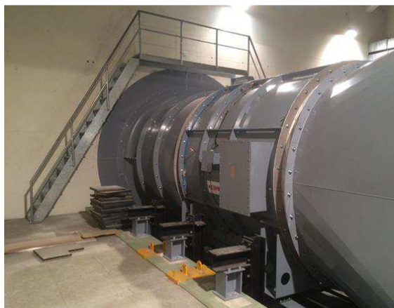
Ventilatore assiale per ventilazione longitudinale (ugello Saccardo)
