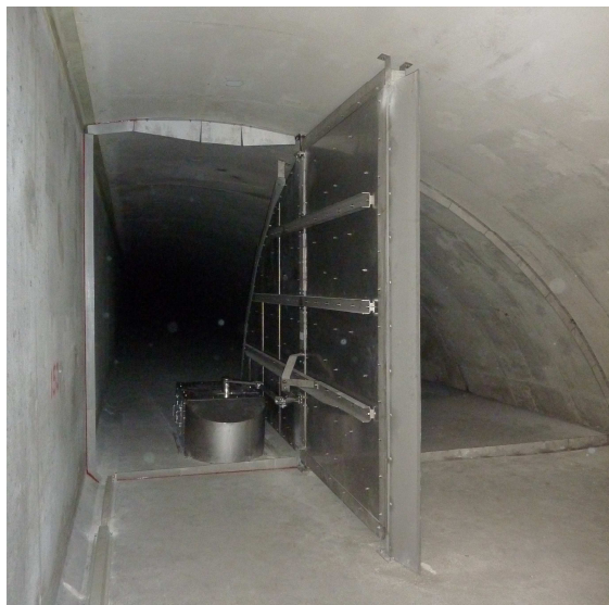
Serranda di separazione del canale
