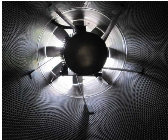
Impianti tecnici in galleria
