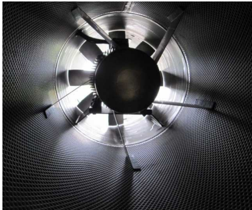
Installations techniques dans le tunnel
