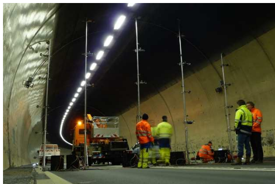
Mesure du réseau pour calibrage des mesures de flux
