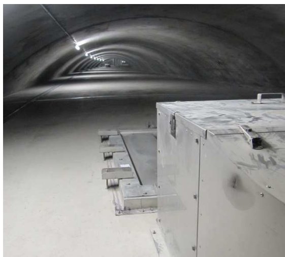
Valvola di scarico fumi nella calotta
