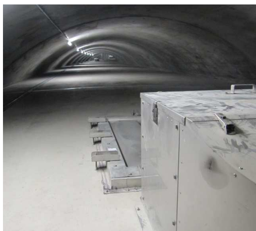
Clapet d'extraction des fumées dans la calotte
