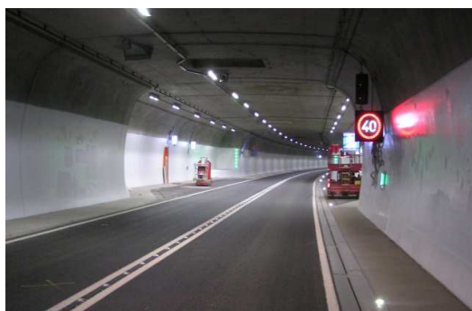
Dégagement pour arrêt d'urgence dans le tunnel
