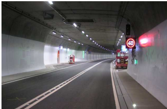
Breakdown bay Gmünder Einhorn-Tunnel
