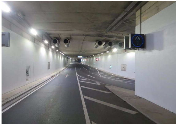
Accesso con gruppo di ventilatori a getto nella galleria Kö-Bogen
