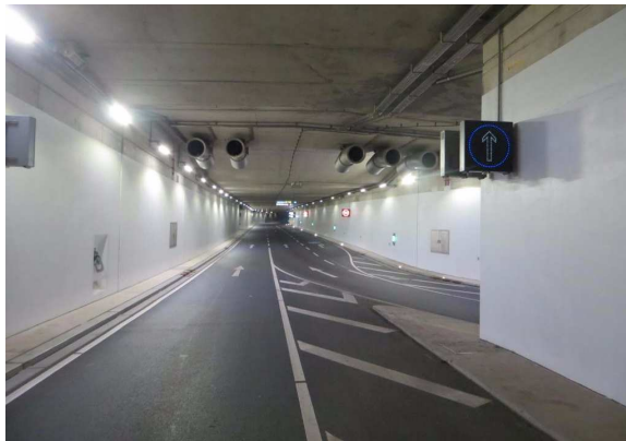
Accès avec groupe de ventilateurs soufflants dans le tunnel Kö-Bogen
