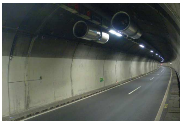
Nuovi ventilatori a getto nella galleria Piomogna
