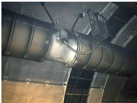
Ventilatore a getto prima del risanamento
