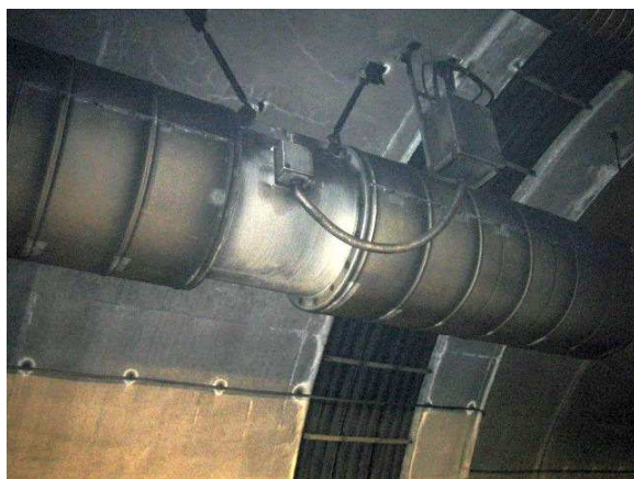
Ventilateur de jet avant assainissement
