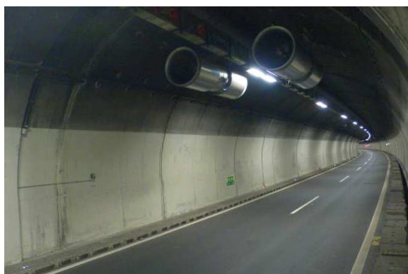
Nouveaux ventilateurs de jet dans le tunnel de Piumogna
