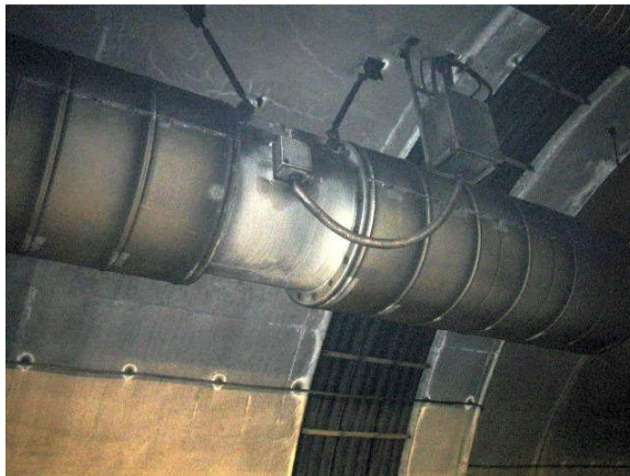
Jet fan before retrofit
