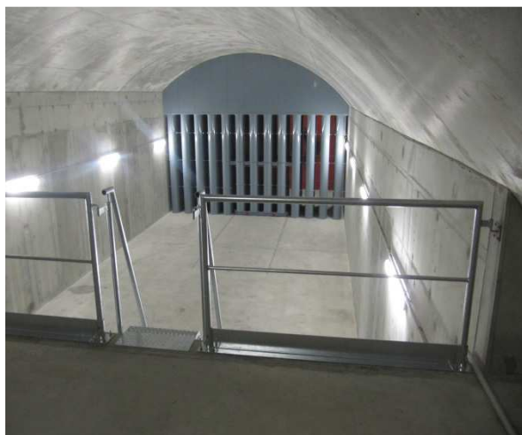
Centrale di espulsione aria con silenziosi
