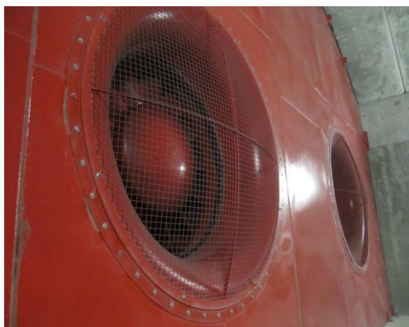
Ventilatori assiali della centrale di espulsione aria con parete di chiusura in acciaio sul lato aspirazione
