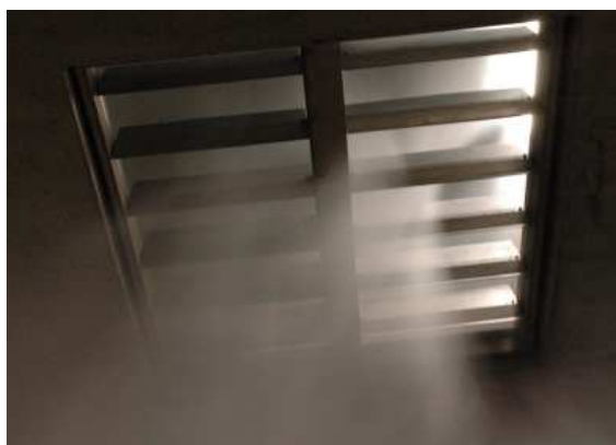
Aspiration par clapets d'aspiration de l'air vicié dans des conditions de fonctionnement normales et aspiration des fumées en cas d'incendie
