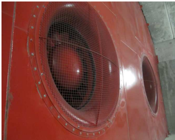
Axialventilatoren der Abluftzentrale mit saugseitiger Stahlabschlusswand
