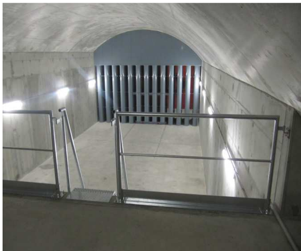
Abluftzentrale mit Schalldämpferkulissen
