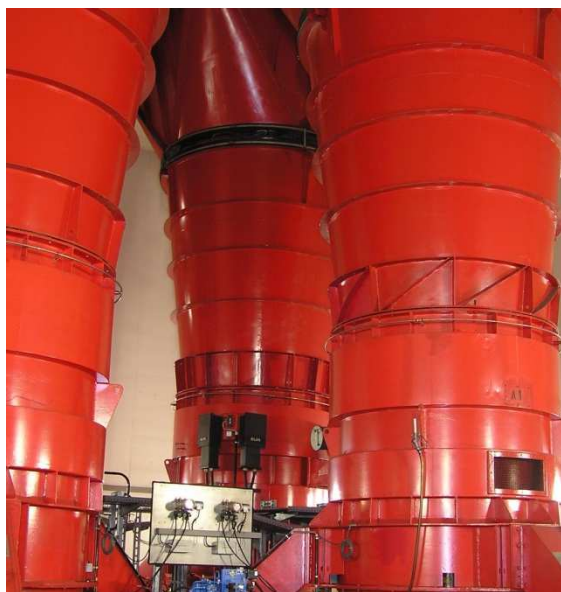
Ventilatori della centrale di espulsione aria viziata
