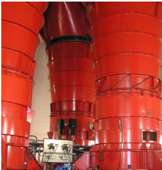
Ventilateurs de l'unité centrale d'extraction d'air vicié
