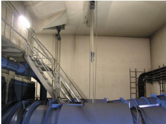
Montage dans le cadre du remplacement des ventilateurs axiaux d'extraction de la fumée
