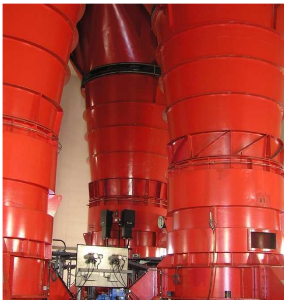
Ventilatoren der Abluftzentrale
