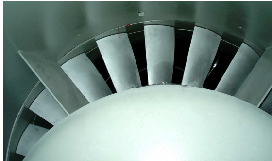
Ventilatore di aspirazione dell'aria
