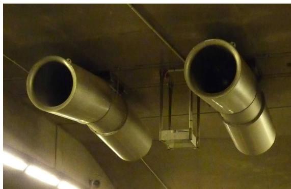
Gruppo di ventilatori nell'uscita verso Vogelweideplatz
