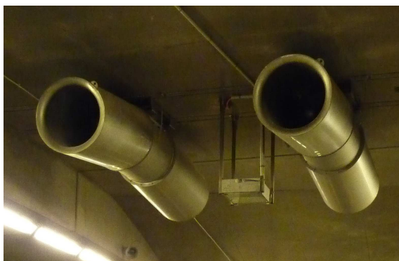
Groupe de ventilation à la sortie de la Vogelweideplatz
