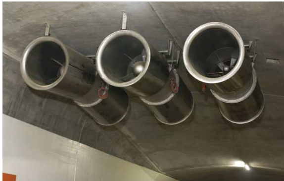
Ventilatori a getto in una nicchia nel soffitto della KWT
