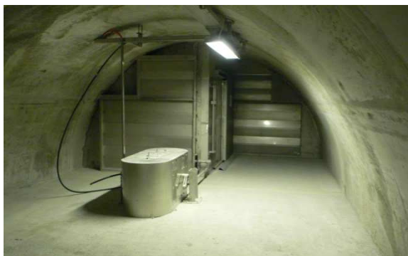
Clapet de rameau entre les tubes Nord et Sud du KWT
