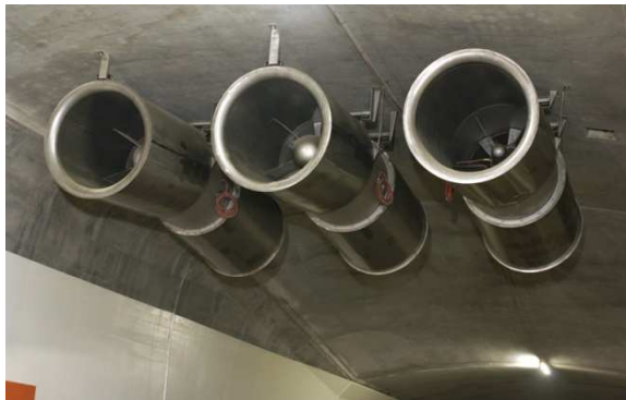
Ventilateurs de jet dans une niche en voûte du KWT
