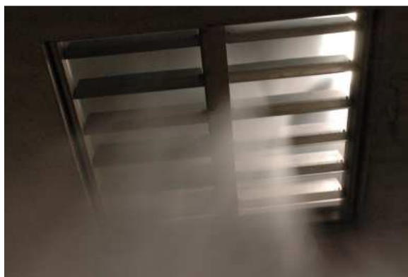
Estrazione dei fumi attraverso una serranda
