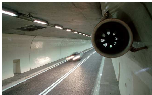
Vano traffico con ventilatore ad impulso
