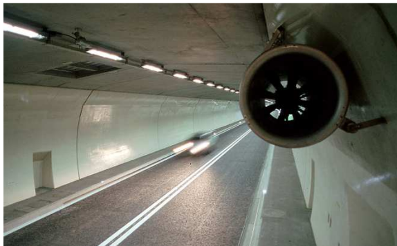
Espace réservé à la circulation avec ventilateur à jet
