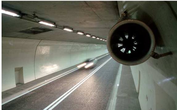
Tunnel jet fan
