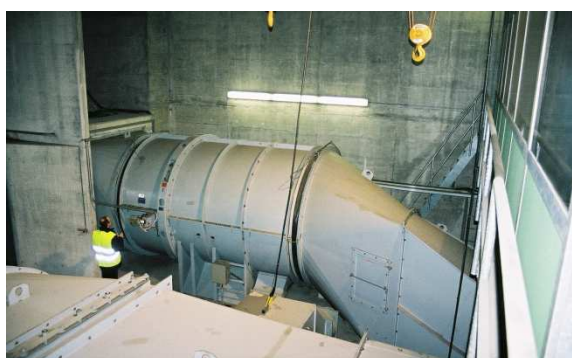
Ventilatore per l'estrazione dei fumi prima del risanamento
