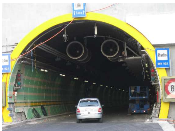
Ventilatori a getto in corrispondenza del portale nord della galleria Berna/Lucerna
