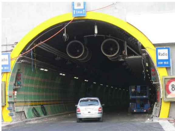
Ventilateurs de jet au portail nord du tube Berne/Lucerne
