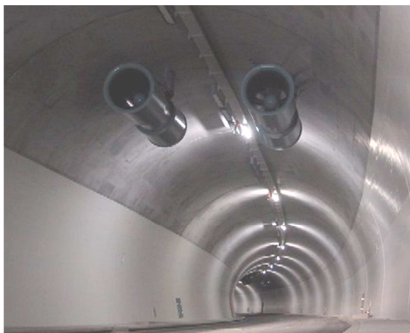
Ventilatori a getto presso il portale sud
