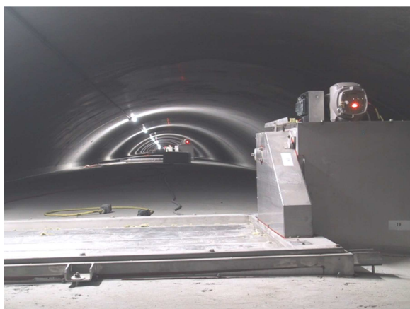
Canale di scarico dell'aria con serrande e motore di azionamento di una serranda in primo piano
