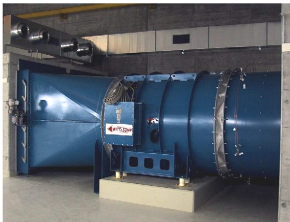
Ventilatori di aspirazione dell'aria per esercizio normale e in caso d'incendio
