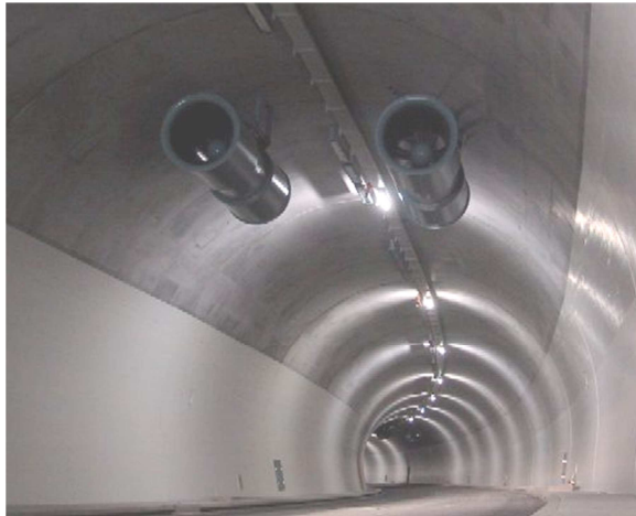
Ventilateurs de jet au portail sud du tunnel
