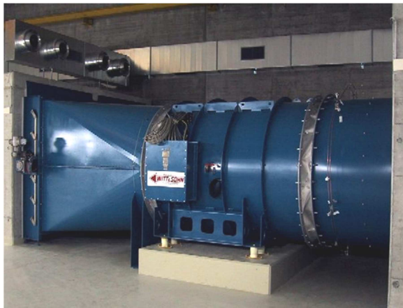
Ventilateurs d'aspiration d'air pour l'exploitation normale et en cas d'incendie
