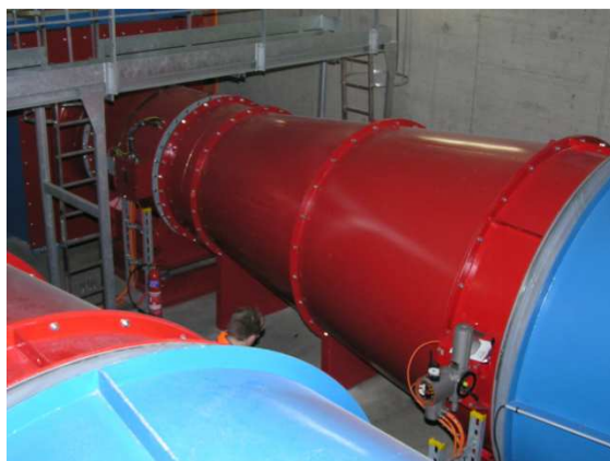
Nuovi ventilatori di evacuazione fumi "Kniebrücke"
