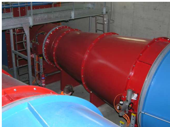
Ventilateur d'air vicié du désenfumage "pont-coude"
