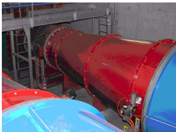
Neue Abluftventilatoren Entrauchung "Kniebrücke"
