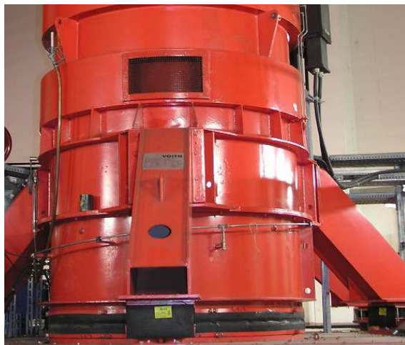
Ventilateur d'air usé A1 dans la station d'air usé
