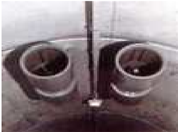
Strahlventilatoren mit Drehzahlregelung
