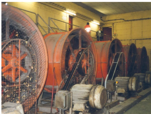
Ventilatori di immissione d'aria fresca prima del risanamento
