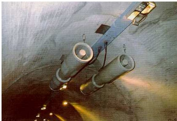
Installation complète et raccordement des ventilateurs de jet
