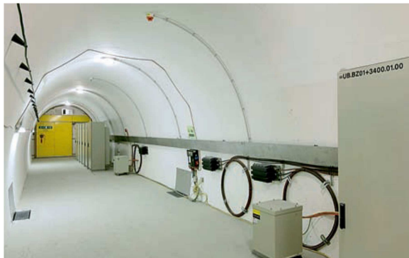
Armadi elettrici in un cunicolo trasversale di alloggiamento degli impianti tecnici della galleria
