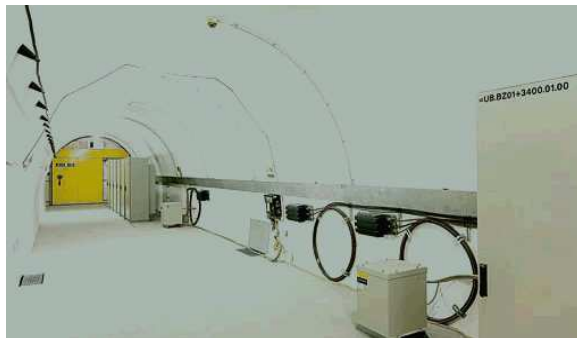
Armoires électriques dans une galerie transversale abritant la technique ferroviaire
